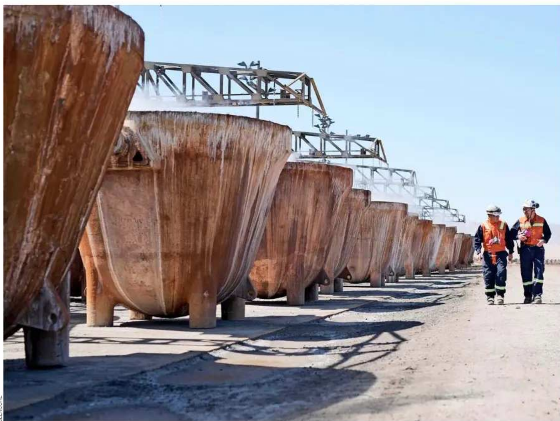
El Complejo Metalúrgico Altonorte puso en marcha un innovador sistema de enfriamiento de escoria en ollas, enmarcado en los lineamientos de eficiencia hídrica.
